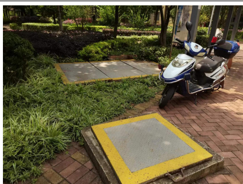
再生水处理站
